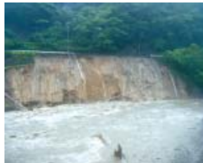
河川の氾濫で県道黒部・西川線が陥没 ガードレールが崩落
