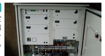
直流電源装置
