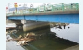
津波後の橋脚(宮城県気仙沼市)
