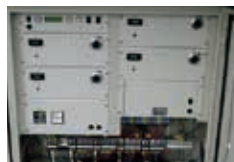
直流電源装置
