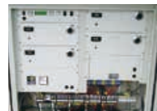
直流電源装置
