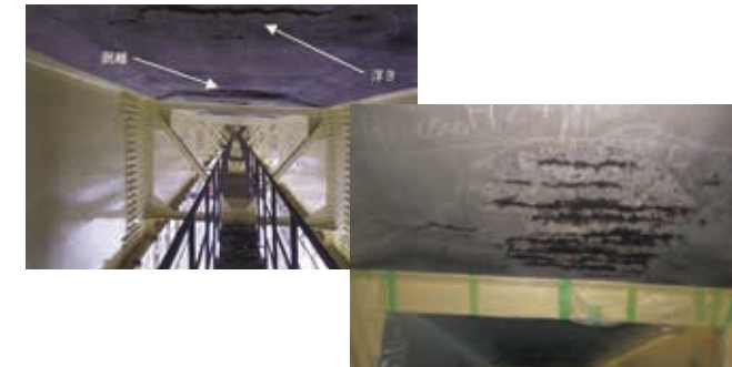
劣化が顕著となった床版（下部）
