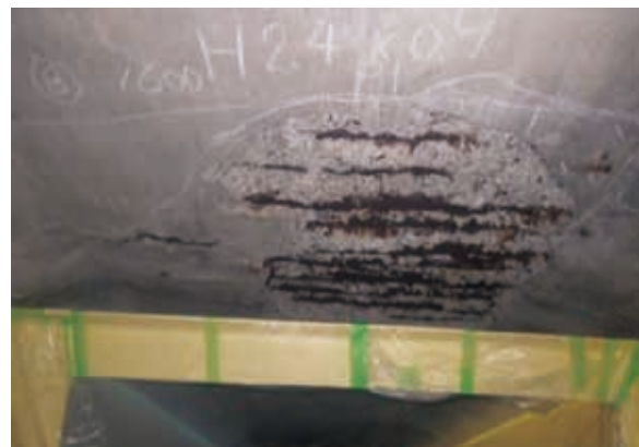
劣化が顕著となった床版(下面)
