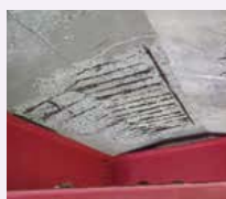
劣化したRC床版
