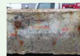
鉄筋の腐食とひび割れ
