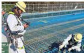
音声入力システム(吉原高架橋)
