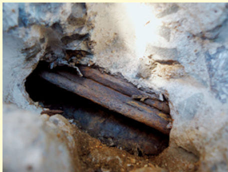
PC鋼材の腐食事例
