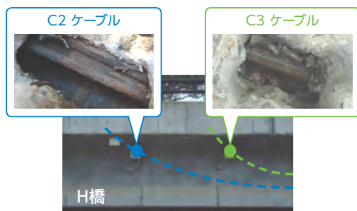
施工前のPC鋼材の腐食状況とモニタリング位置
