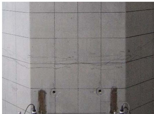
写真-5 ひび割れ状況(引張側)
