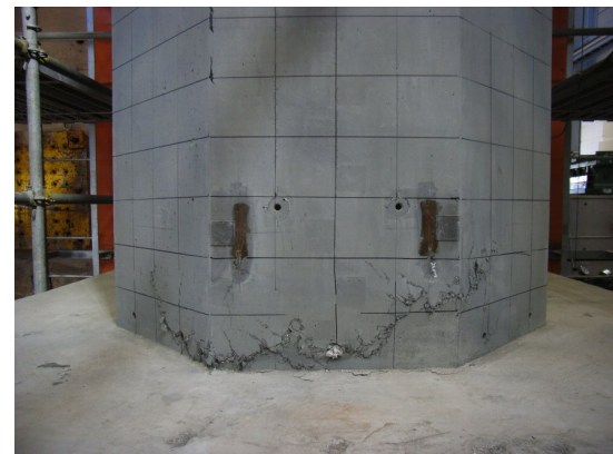
写真－４ 破壊状況(基部圧縮縁)
