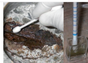
錆層内の塩化物イオン調査
