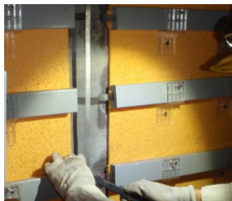
陽極間および陽極－電源装置、鋼材－電源装置間の配線
