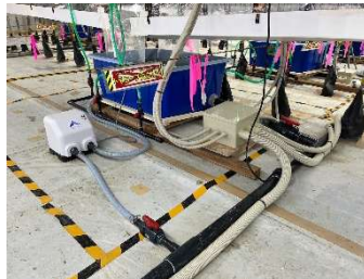
溶液循環設備の設置状況
