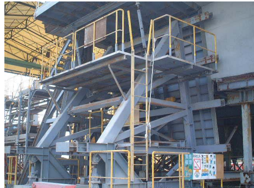
写真-8 側枠設備
