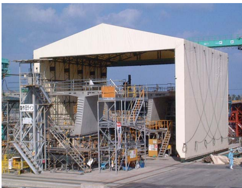
写真 - 1 移動式上屋設備
