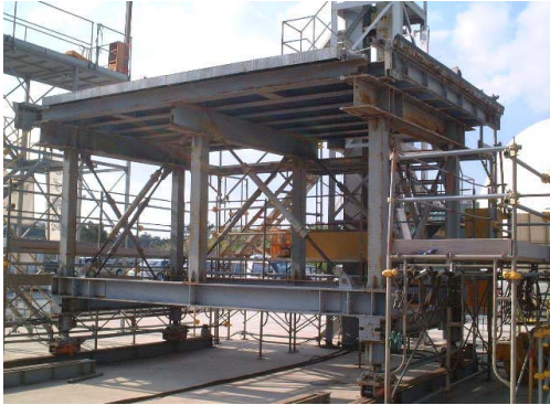
写真 - 11 底枠設備
