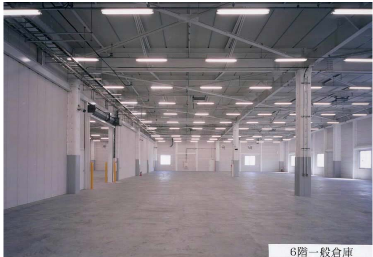
写真-2 6階天井：ハット鋼の上にGWボード
