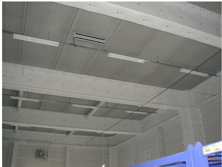
写真-3 一般階天井：スパンクリート、搬送ファン
