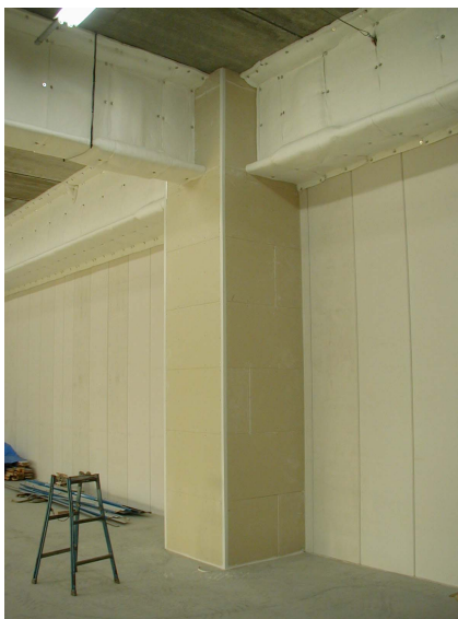
写真-8 3階柱：石膏ボード
