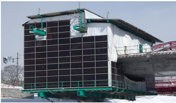
写真-3 ワーゲンの外観
