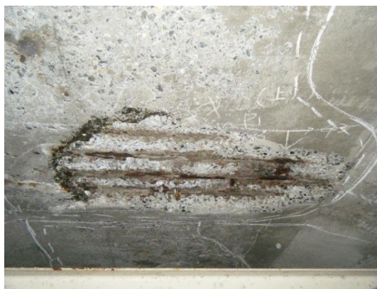
写真-1 床版下面の劣化状況
