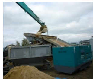
写真-5 圧送設備
