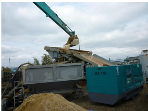
写真-6 圧送設備
