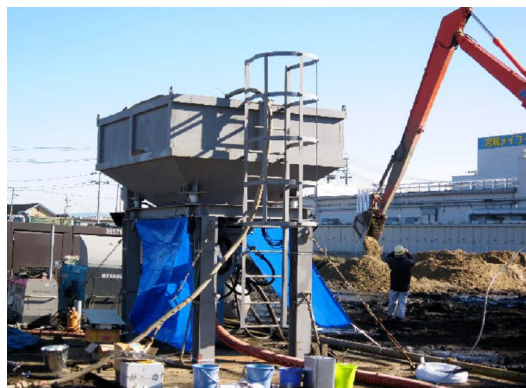
写真-1 圧送設備
