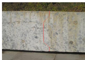
写真-3 ひび割れ状態
