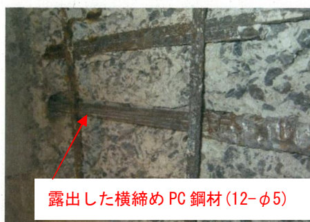
写真-1 端支点横桁で確認された横締めのグラウト充填不足
