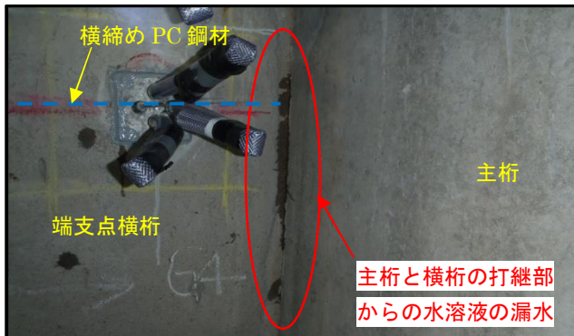
写真-3 亜硝酸リチウム水溶液の漏出状況
