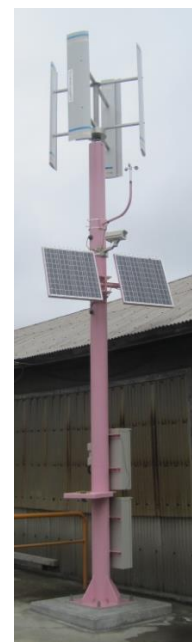
写真-1 小型風力発電機
