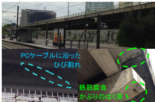
写真-6 パリ環状高速道路の高架橋における劣化状況
