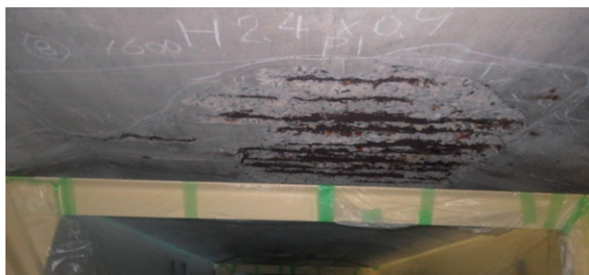
写真-1 既設 RC 床版下面の劣化状況
