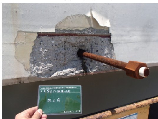
写真-2 鋼棒突出状況（接写）
