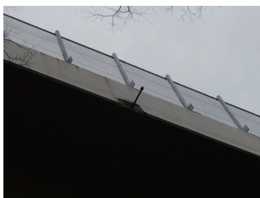
写真-1 鋼棒突出状況
