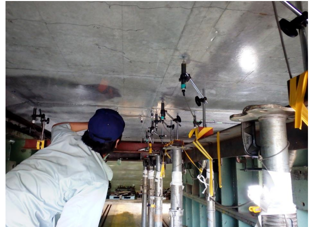
写真-6 漏水確認状況(曲げ定着タイプ)
