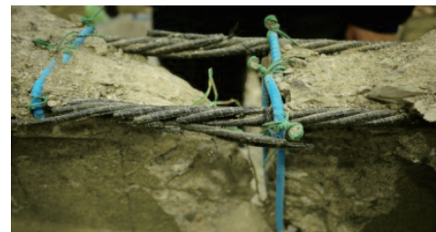
写真-1 圧壊時のPC桁上縁部の状況
