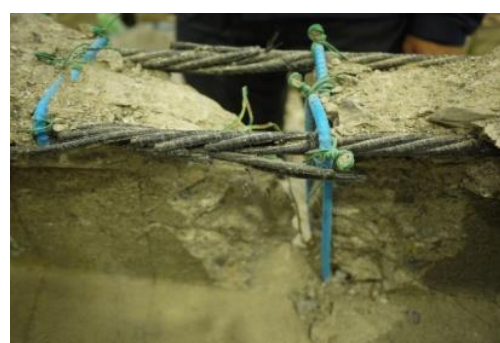
写真-1 圧壊時の PC 桁上縁部の状況
