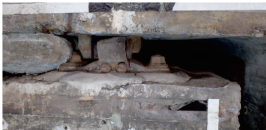
写真-1 ゲルバー部支承損傷状況
