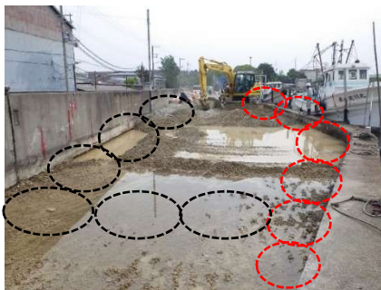
写真-3 ①掘削時の浸水状況
