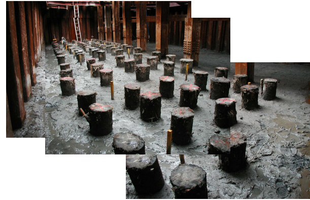
写真-2 杭頭の露出状況
