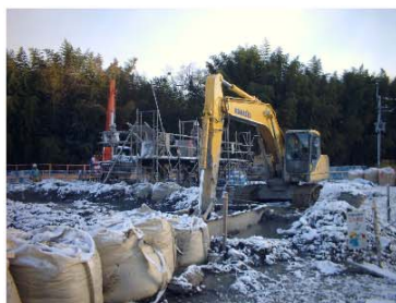
写真-6 攪拌積込み用バックホウ
