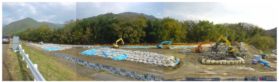
写真-10 脱水ヤード全景
