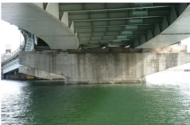
写真-1 補修前の橋脚の劣化状況
