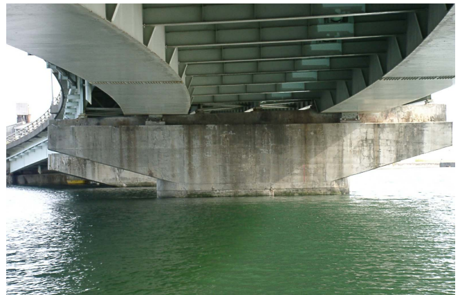
写真-1 補修前の橋脚の劣化状況
