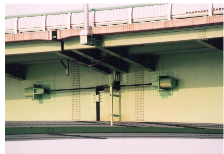
写真-3 扇大橋の 3DSole 弾性連結装置
