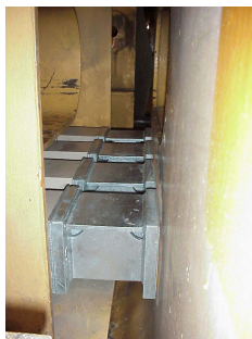
写真-5 新荒川大橋の弾性連結装置
