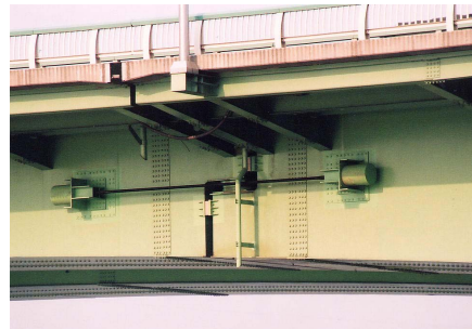
写真-4 扇大橋の弾性連結装置
