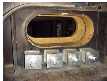
写真-6 新荒川大橋の弾性連結装置
