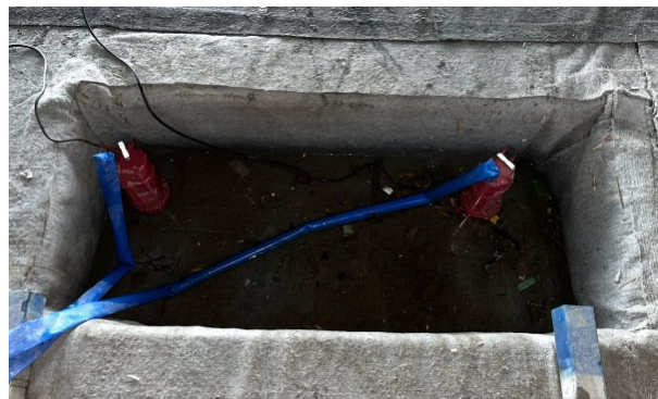
写真-6 下段作業台の水溜め桶
