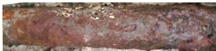
写真-3 No.214 鋼棒の測定②における減肉状況
