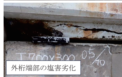
外桁の塩害劣化
