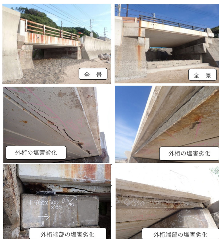
写真-1 対象橋梁の外観、塩害劣化状況
