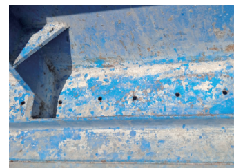
写真-2 残留気泡排出孔
