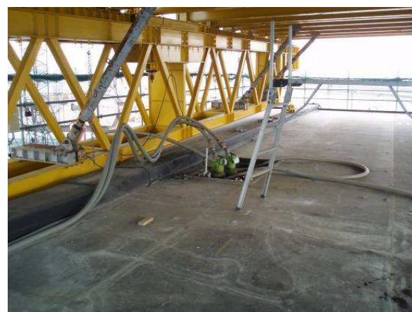
写真-9 ワーゲン下段作業床の排水設備
