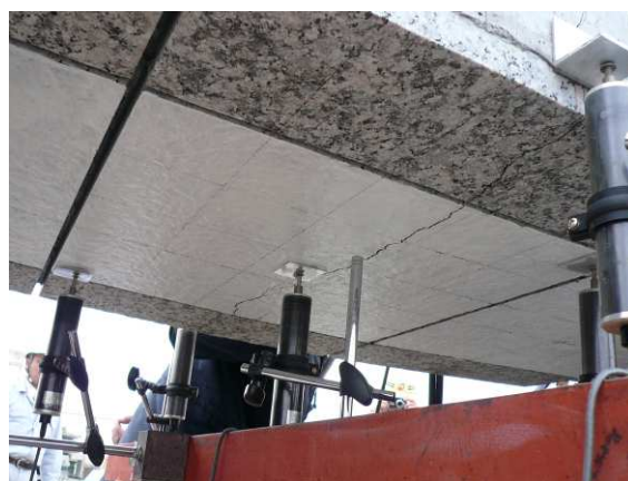
写真－５ 石材のひび割れ(No.①)
