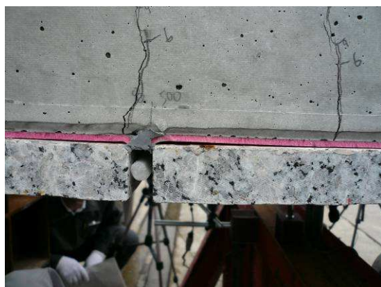
写真－６ 石材とコンクリートの離間(No.⑤)
