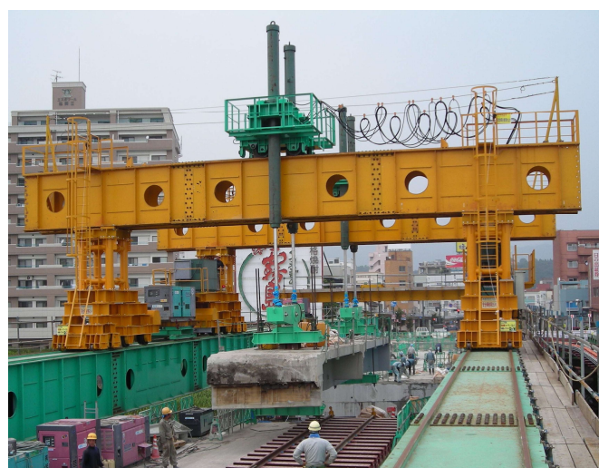
写真-4 橋形クレーン全景
