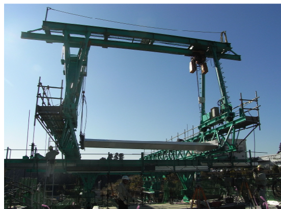
写真－6 橋形クレーン
