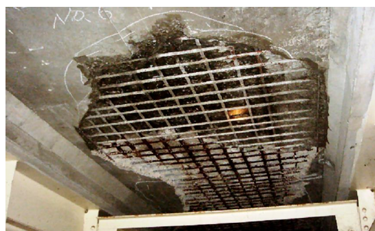
写真-1 床版の劣化状況
