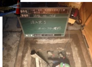
はい管いつ流状況
